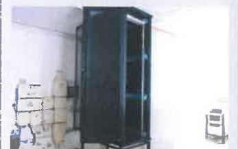
Zweiter Serverschrank im Aufbau
