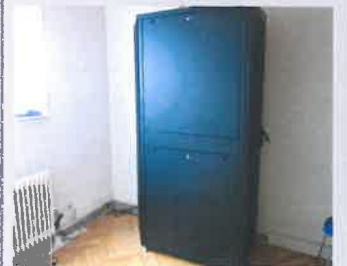
Serverschrank im Aufbau
